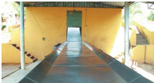
Mesa de triagem da Unidade de Triagem e Compostagem de Lixo do município de Presidente Kubitschek (MG)
