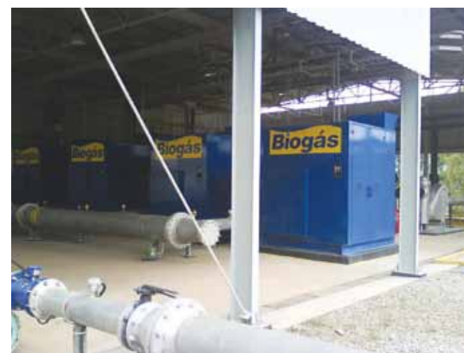
Foto 14: Sopradores de gases no aterro sanitário de Bandeirantes - SP
