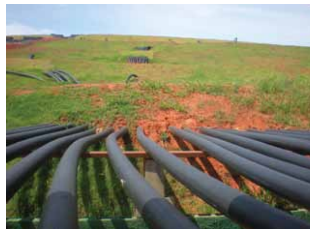
Foto 13: Captação de gases no aterro sanitário da Estre em Paulínia - SP
