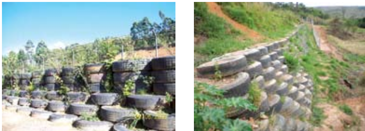
Figuras 7 e 8 – Muro de contenção com pneus, prática não recomendada
